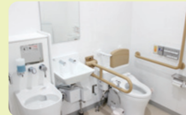
◆多目的トイレ
